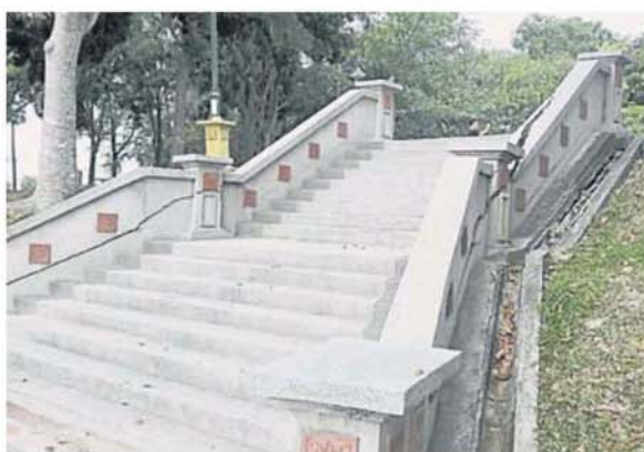
梯级也出现裂缝。
